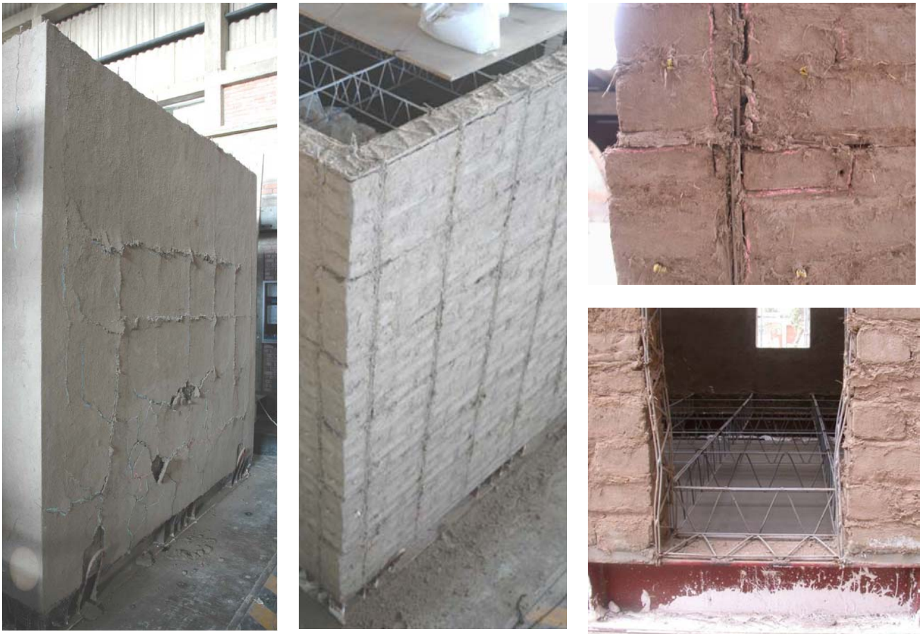
Figura 12. Vista de distintos agrietamientos aparecidos y del pandeo de la Costilla de la puerta.
