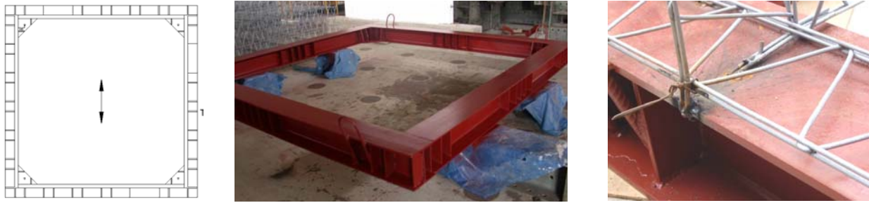
Figura 7. Anillo metálico de la planta cuadrada de la vivienda a ensayar y soldado de costillas.
