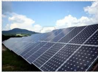
Campo de placas solares
